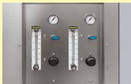
Sistema di gasaggio automatico con valvola elettromagnetica e flussometro a galleggiante
